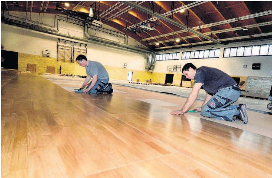
Die Sanierung der Turnhalle der Berufsschule neigt sich dem Ende. Tobias Schwarz (links hinten) und Hartmut Kartheus verlegen rund 1 100 Quadratmeter Sportboden. Nach den Winterferien wird die größte Zeitzer Turnhalle wieder der Nutzung übergeben.
