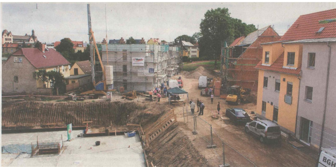
Die Wohnhäuser des „1. Mai“ haben schon Gestalt angenommen, für das Wohngebäude der Volkssolidarität ist jetzt der Grundstein gelegt.
